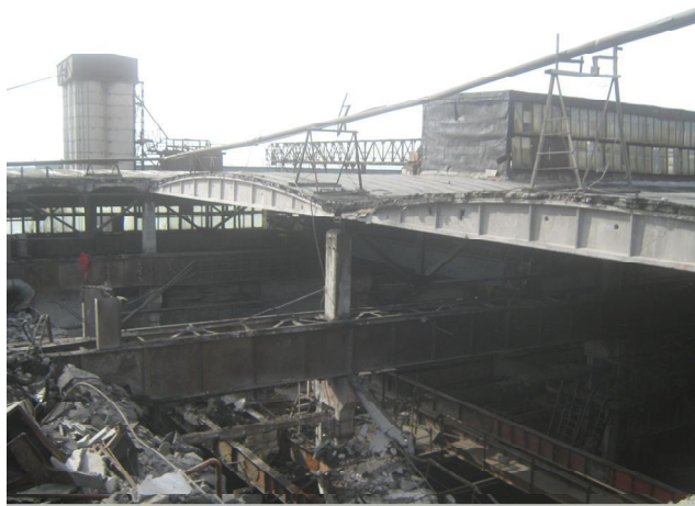
Рисунок 1 – Общий вид обрушения
