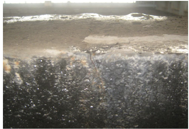
Рисунок 3 – Усталостная трещина в стыке нижнего пояса подстропильной фермы
