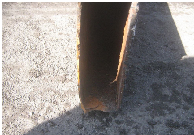
Рисунок 2 – Вид разрушенного нижнего пояса подстропильной фермы
