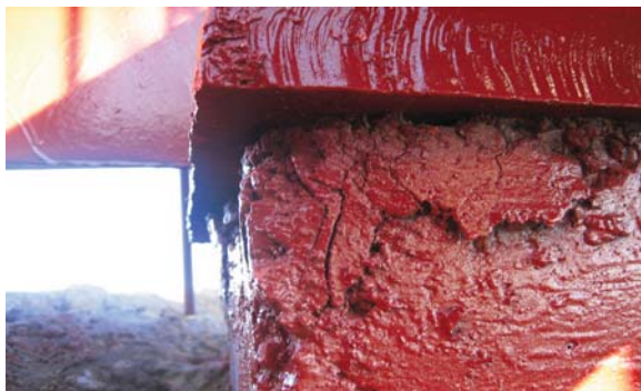
Рисунок 4 – Дефекты опорного фундаментного столба башни Акколь
